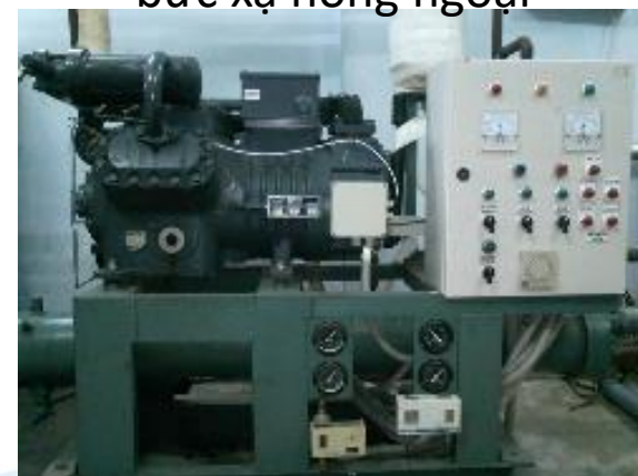
Hệ thống lạnh
